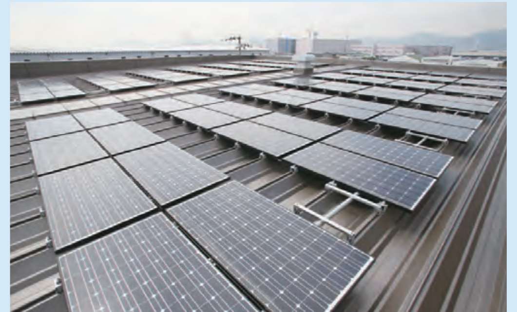
太陽光発電システム
