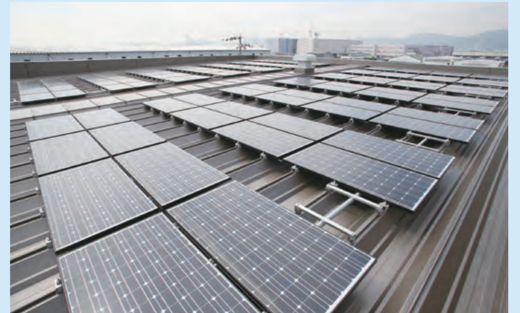
太陽光発電システム
